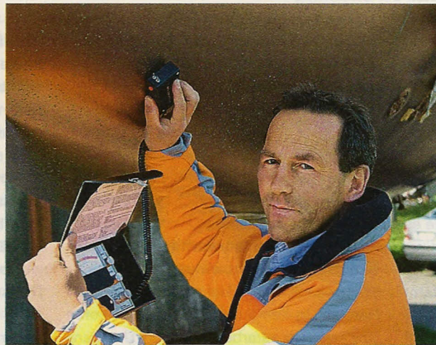
Sanierungsexperte Wrede bei der Feuchtigkeitsmessung
