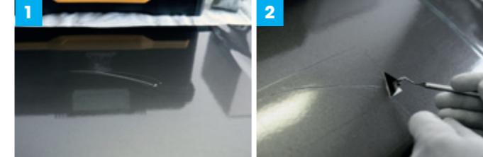
Bei Beschädigungen der Folie (1) lässt sie sich mit einem Patch reparieren. Mit dem Cutter wird der Bereich ausgeschnitten und entfernt (2).
