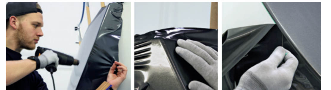
Mit Wärme lässt sich die Folie dehnen und faltenfrei über die Kanten ziehen (links, Mitte). In dem Tape sitzt ein feiner Faden, mit dem die Folie entlang der abgeklebten Kante geschnitten wird (rechts)
