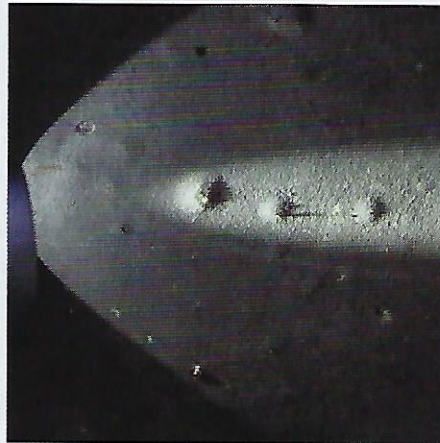
Das Streiflicht lässt die Blasen sichtbar werden.
